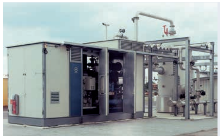
VMY 336 M - Verdichtung von Erdgas
